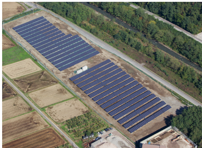
松本太陽光発電所
