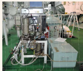
「ひまわり8」機関室内に設置された海洋計測機
