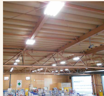
倉庫天井に設置したLED照明
