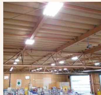
倉庫天井に設置したLED照明
