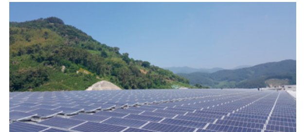
倉庫屋上の太陽光パネル
