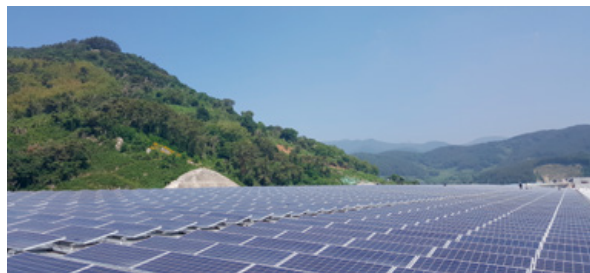
倉庫屋上の太陽光パネル
