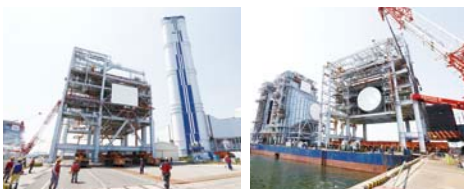
東京電力様 川崎火力発電所
