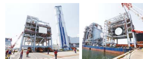
東京電力様 川崎火力発電所
