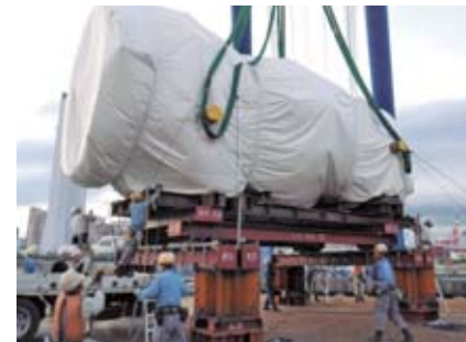
タイから輸送された発電設備
