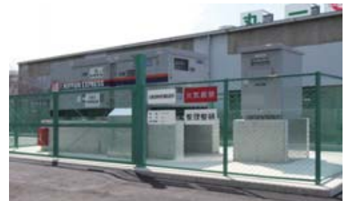
非常用発電機
