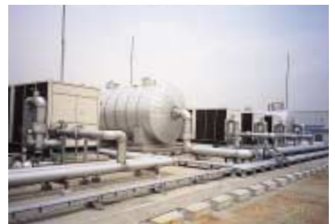
蓄熱式冷却設備
