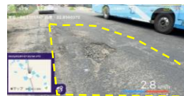
穴及びひび割れ
